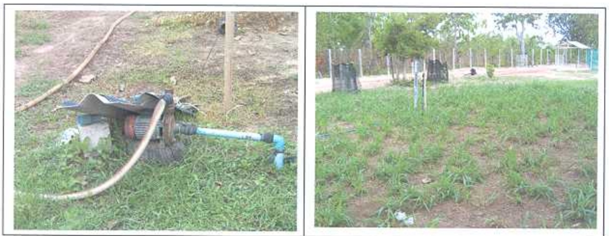
ภาพที่ 12 การให้น้ำชลประทาน โดยการสูบน้ำจากบ่อบาดาลหรือบ่อน้ำดินด้วยมอเตอร์ไฟฟ้าขนาดแรง 1 – 1.5 แรงม้า และรดน้ำแปลงหญ้าพืชอาหารสัตว์ด้วยระบบสปริงเกอร์ขนาดเล็ก (mini spinkler)
