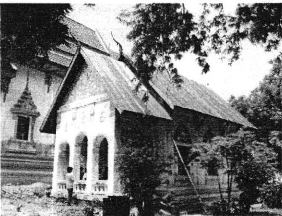
ภาพก่อนการซ่อมบูรณะหลังคาสิมวัดโนนศิลา
