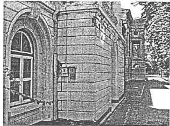
ตู้ควบคุมที่อยู่ภายนอกอาคาร
