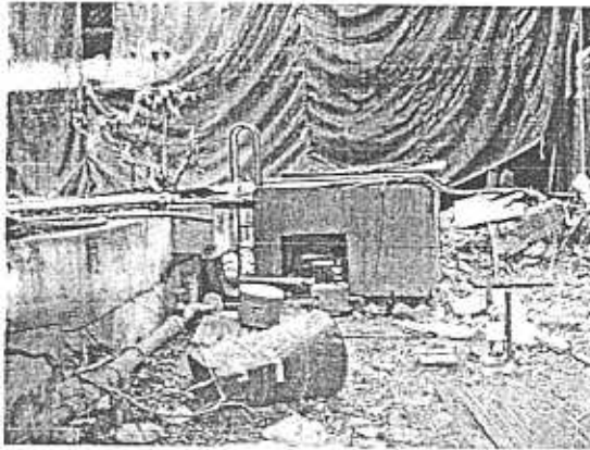
ถังเก็บน้ำและเครื่องสูบน้ำ
