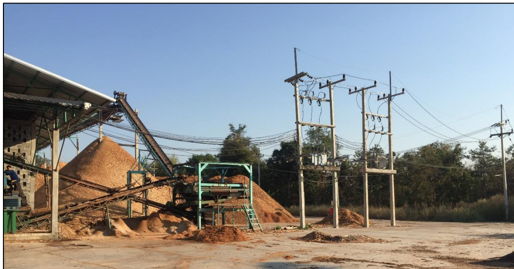
ภาพที่ 4.10 บริเวณระบบผลิตชิ้นไม้ยูคาลิปตัสสับ และบริเวณที่ติดตั้งหม้อแปลงไฟฟ้า
